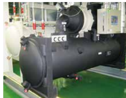
導入したターボ冷凍機
