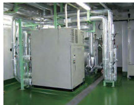
廃熱回収ヒートポンプ
