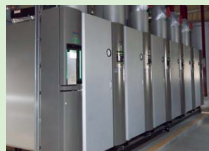
小型ボイラー
