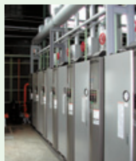
都市ガス利用貫流ボイラー
