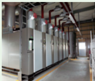
小型ボイラー
