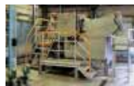
排水汚泥脱水機
