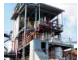
しょうゆ粕専用ボイラー
