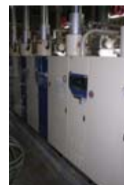
< 貫流ボイラー > 熱効率の良い12t/hの小型ボイラー
