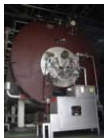
< 煙管ボイラー > 15t/hの大型ボイラー
