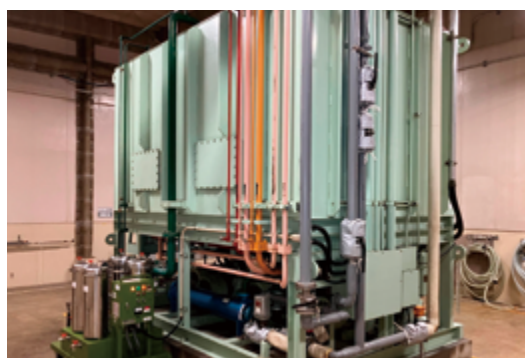
圧搾作動油オイルクーラー (キッコーマン食品(株)高砂工場)
