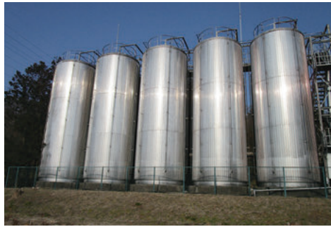
製麹室(上)と屋外発酵タンク(福島県醤油醸造協同組合)
